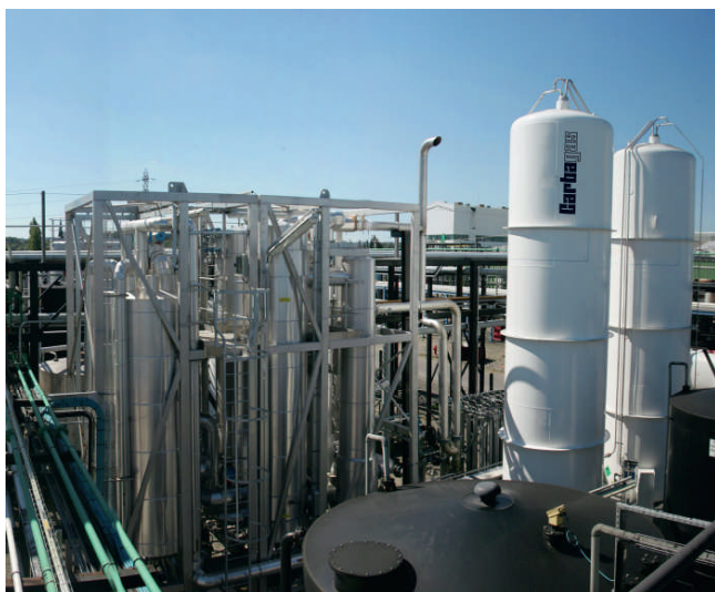
Abluftreinigung: Bei der Anwendung «Voxal» werden flüchtige organische Verbindungen (VOC) kondensiert und aufgefangen.
